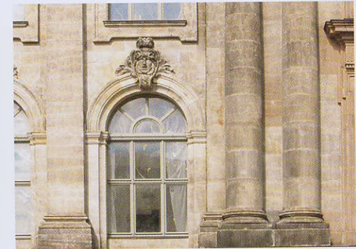
112 Fassadenfläche am Bodemuseum, die durch einen Rohrbruch stark verfärbt wurde
